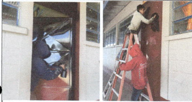
Foto 1: PUERTAS Mantenimiento a estructura (lijado, aplicación de pintura)de las puertas de aulas dirección y cocina.
